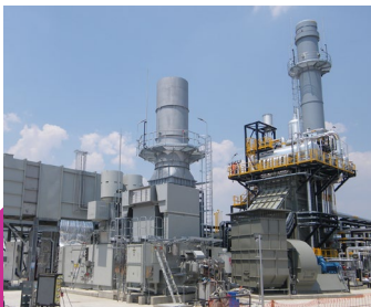
Central de cogeneración de San Juan del Río, México
